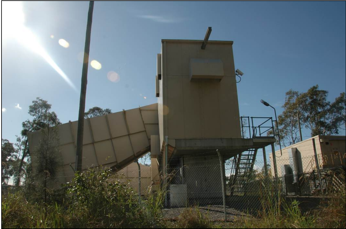
Plate 3 – Ventilation fan A
